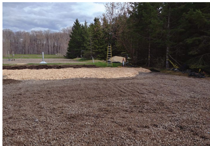
Mise à l'échelle du nouveau média filtrant.
