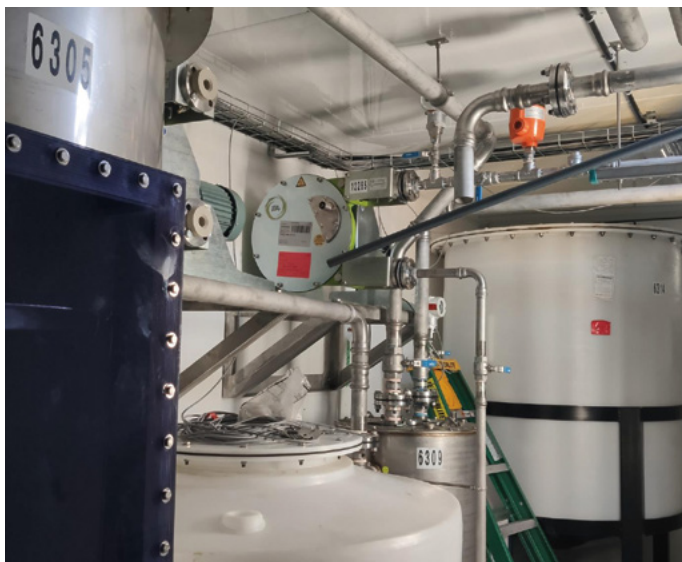
Séparation de la pulpe/eau de procédé, transformation des sous-produits en HCN, colonne de volatilisation (fenêtre bleue).
