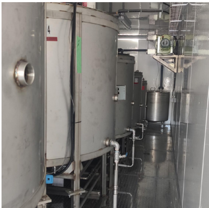
Cuves de cyanuration avec les sous-produits régénérés sans apport de cyanure frais.
